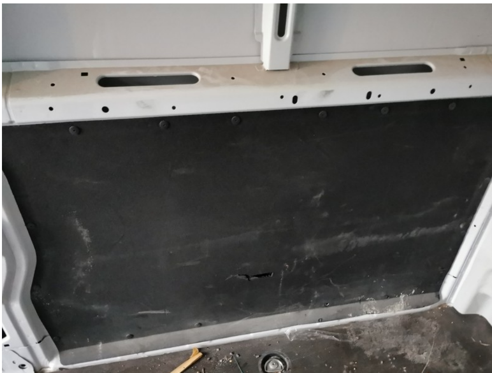
Viz popis k poškození č. 12
